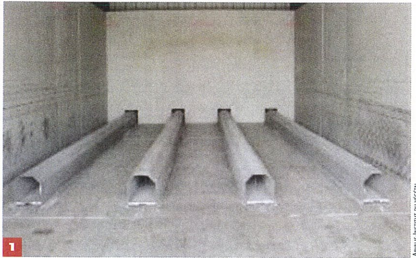
1 Case de stockage conventionnelle avec gaines de ventilation.
